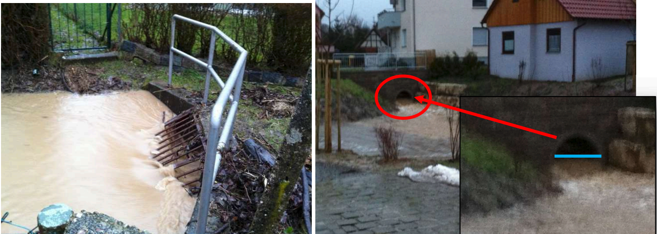
Abb. 8 Überflutung Erlenbachverdolung (links Einlauf Aufnahmezeit 8:27, rechts Auslauf Aufnahmezeit 8:18)
