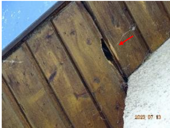
Abb. 14: Loch in Holzverkleidung des Traufbereichs (roter Pfeil) an Nordwestseite des Feuerwehrgebäudes
