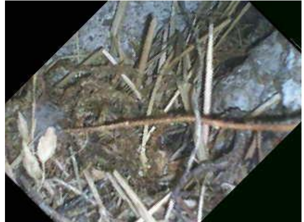
Abb. 24: Endoskopische Aufnahme von Nistmaterial hinter Traufverkleidung an Nordwestecke des Feuerwehrgebäudes
