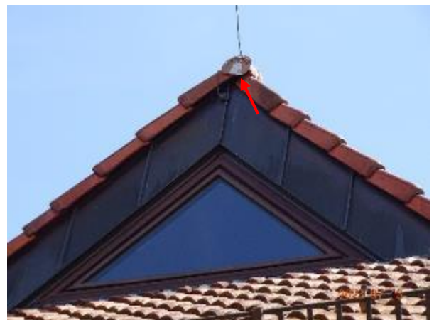
Abb. 18: Spalte an Dachziegeln (roter Pfeil) auf Westseite des Feuerwehrgebäudes
