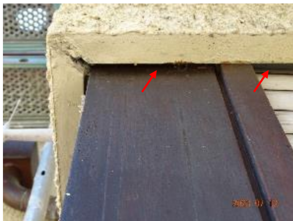
Abb. 17: Spalten an Fassade und Rollladen (rote Pfeile) an Südseite des Feuerwehrgebäudes
