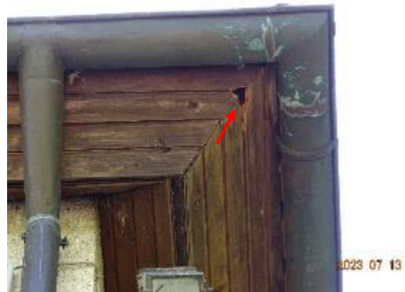
Abb. 15: Loch in Holzverkleidung des Traufbereichs (roter Pfeil) an Nordwestecke des Feuerwehrgebäudes
