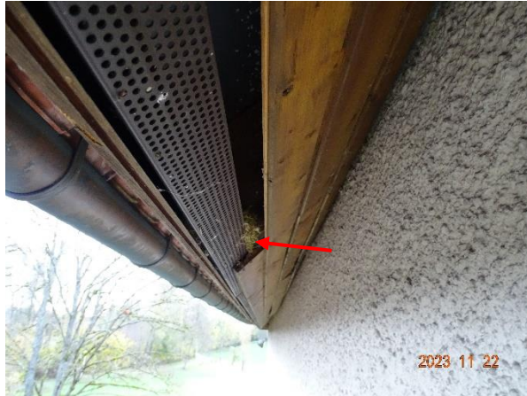
Abb. 23: Traufbereich an südwestlicher Ecke des Feuerwehrgebäudes. Der rote Pfeil zeigt auf Nest eines Hausrotschwanzes.
