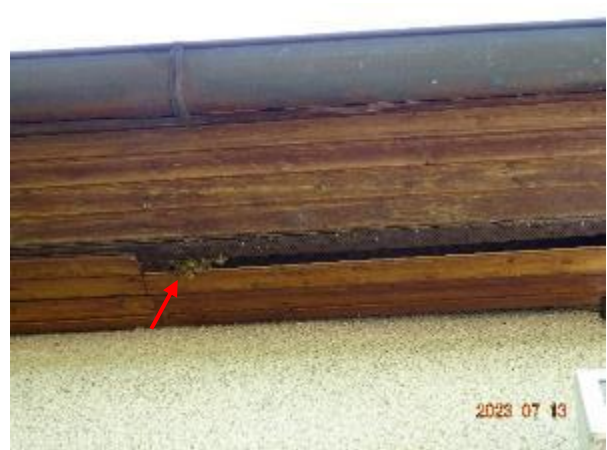
Abb. 13: Abstehende Leiste im Traufbereich an südwestlicher Ecke des Feuerwehrgebäudes. Der rote Pfeil zeigt auf Nistmaterial eines Gebäudebrüters.
